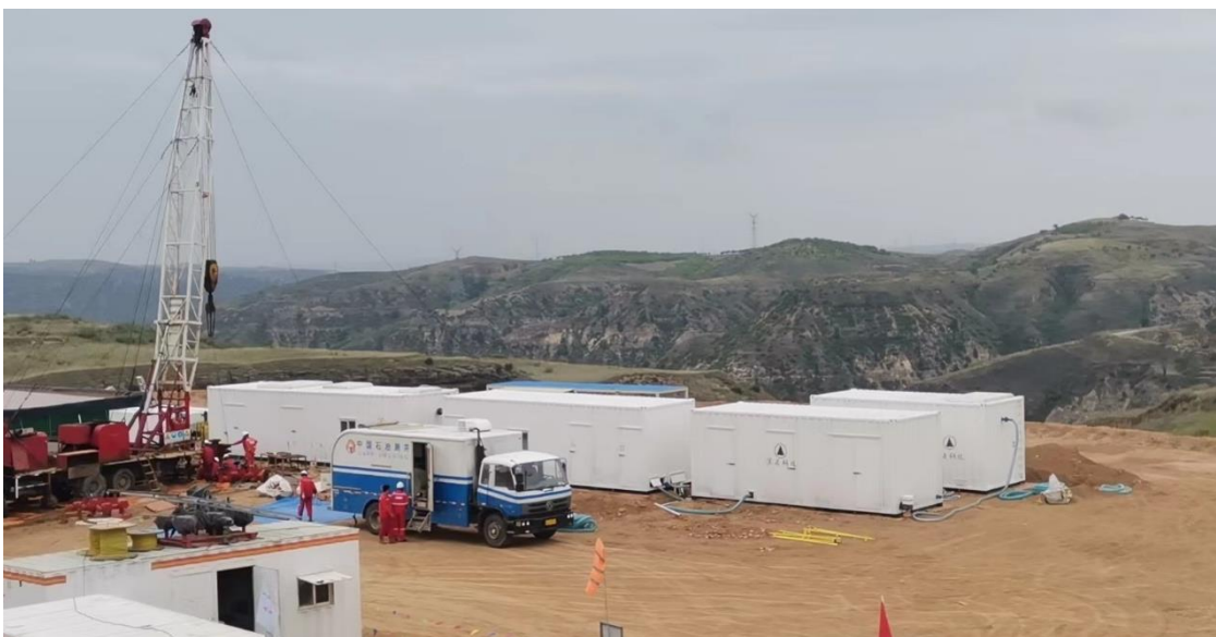
例：深度膜处理系统——榆林府谷压裂返排液撬装式回注处理系统
